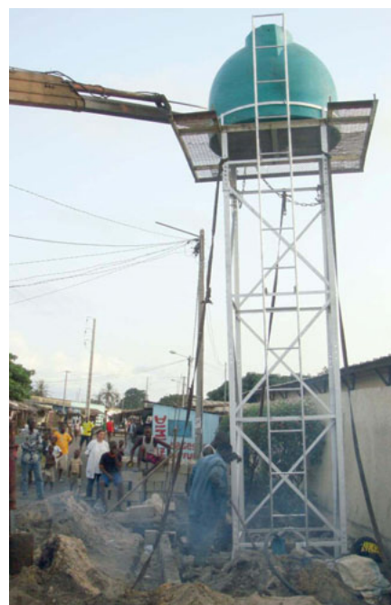
Le château d'eau
